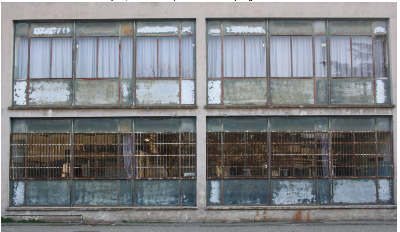
Infissi in stato di degrado manutentivo
