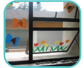
Infissi della scuola media Pezzani
